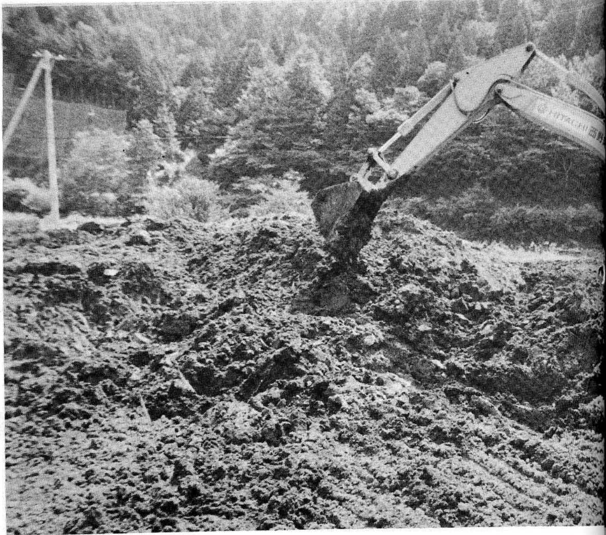
いよいよ始まったほ場整備事業。重機で表土が集められ、しだいに新しい農地へと生まれかわる —日向平第二工区で
