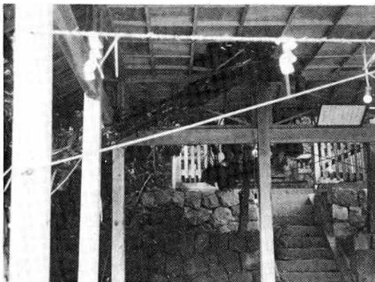
無残に拝殿の屋根を突き破った杉の大木 —大明神子護神社で
