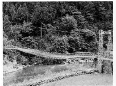
強風でロープが切れ通行不能となった立岩橋
