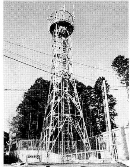
平成8年度事業で中通の山中に建設された移動通信铁塔
