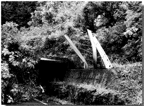
昨年7月の後山線（神戸・平地区）の土砂崩れ
