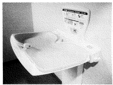
役場本館1階障害者用トイレに設置された交換台
