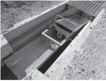
設置された小水力発電機
