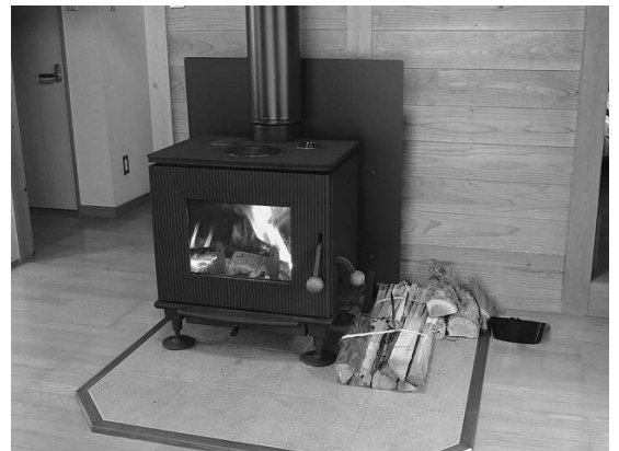
設置された薪ストーブ
