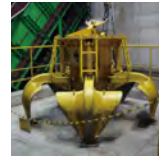
ごみクレーン
